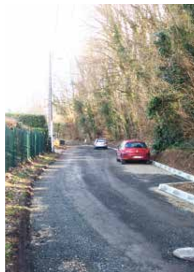
Chemin Creuse Roussillon : reprise des enrobés et création de places de stationnement
